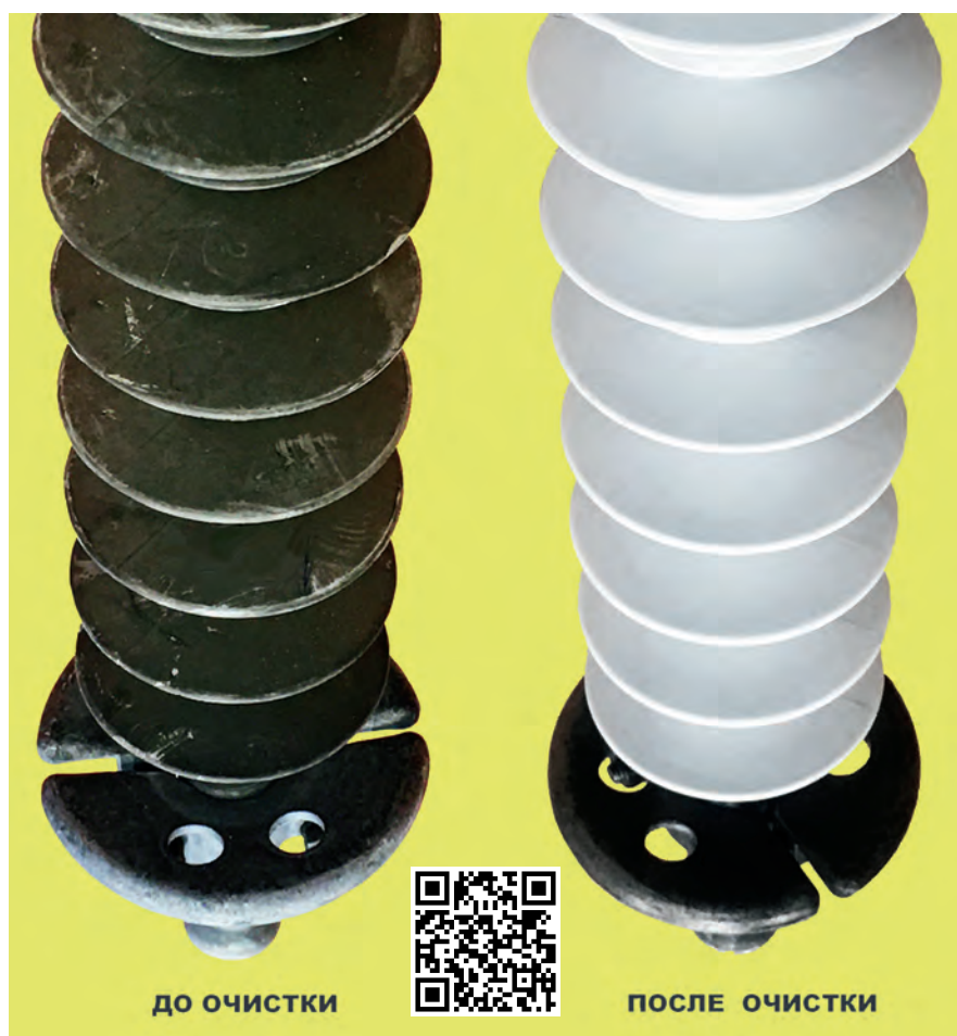
Рис. 1. Линейный подвесной изолятор до и после очистки. Видео очистки по QR-коду
