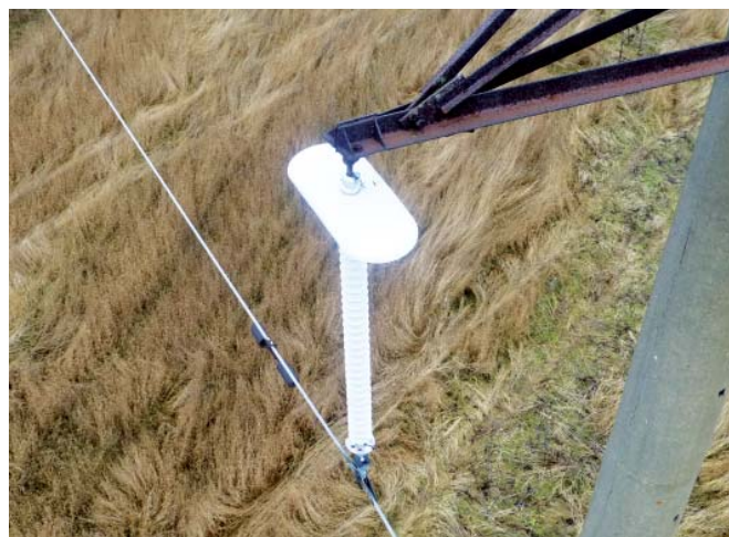
Линейный птицезащищённый изолятор типа ЛКП на ВЛ 110 кВ
